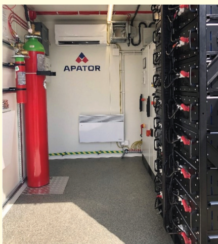
Rys. 16. Magazyn energii Grupy Apator (wnętrze magazynu)
