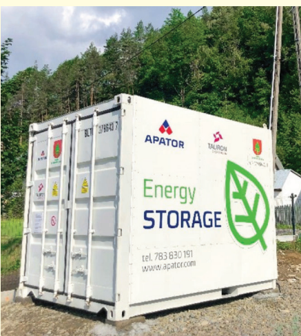
Rys. 15. Magazyn energii Grupy Apator
