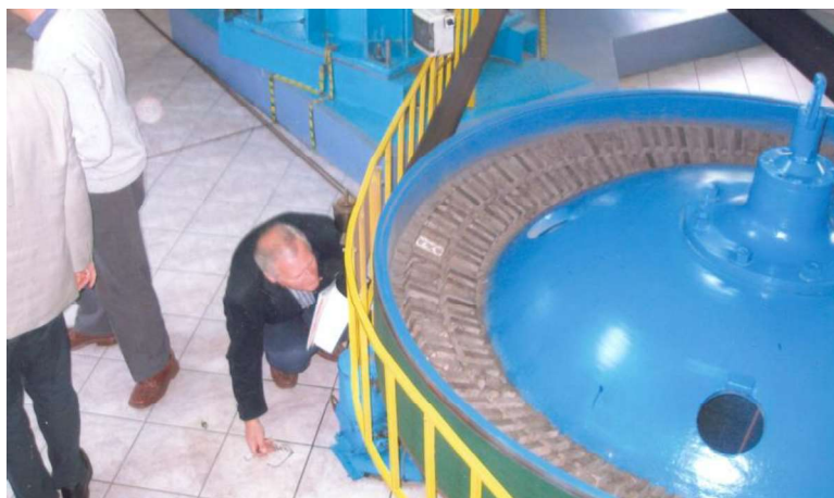
Fot. 5.13. Wycieczka techniczna w Elektrowni Kujawska – czynna przekładnia pasowa turbiny Kaplana (7 czerwca 2006 r.) [3]
